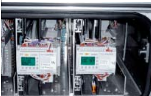
Die Klimaanlage wird durch sieben Mitsubishi Alpha-XL-Steuerungen geregelt
